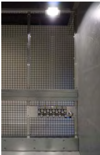
Entnahmestation Techn. Gase
